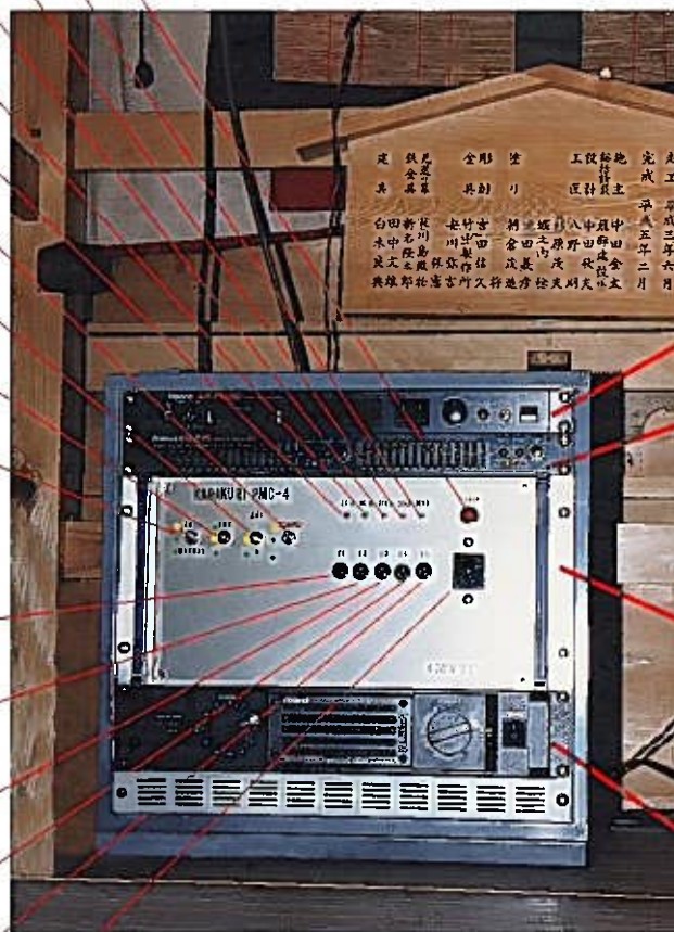
山車(金鶏堂)内部に設置されたコントローラー
